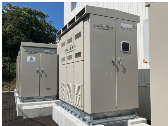
大容量リチウムイオン蓄電池
