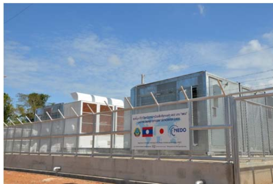
ラオス初の環境配慮型データセンター外観
