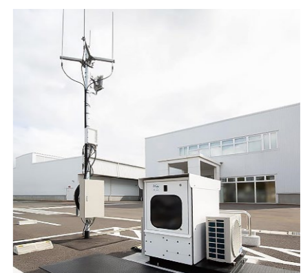
白井DCC敷地内に設置された屋外設置型12Uモデルのマイクロデータセンター
